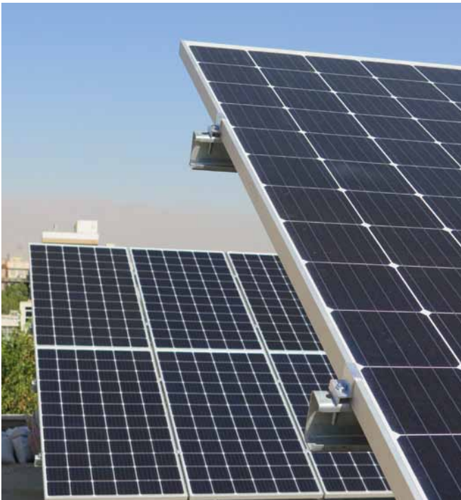
نمایی از تجهیزات نصب شده
