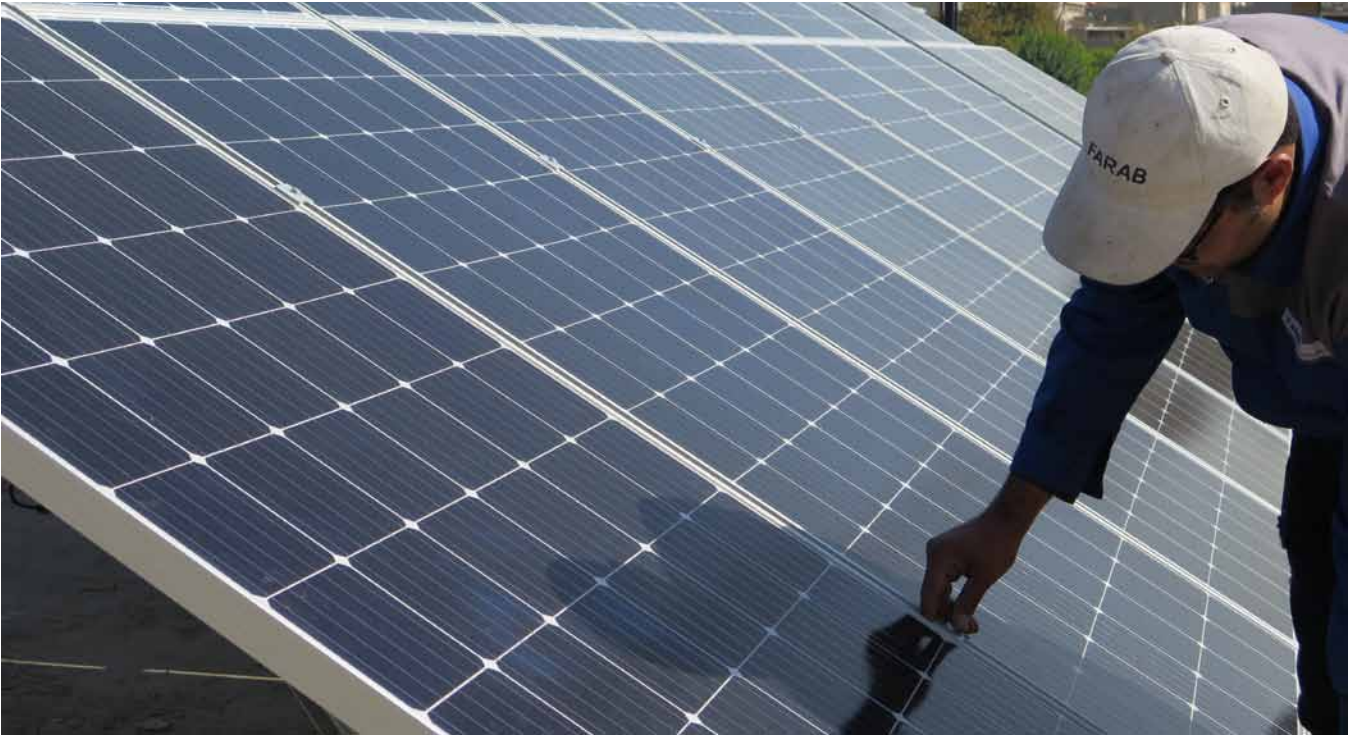
نمایی از تجهیزات نصب شده
