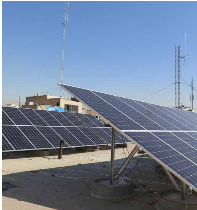
نمایی از تجهیزات نصب شده
