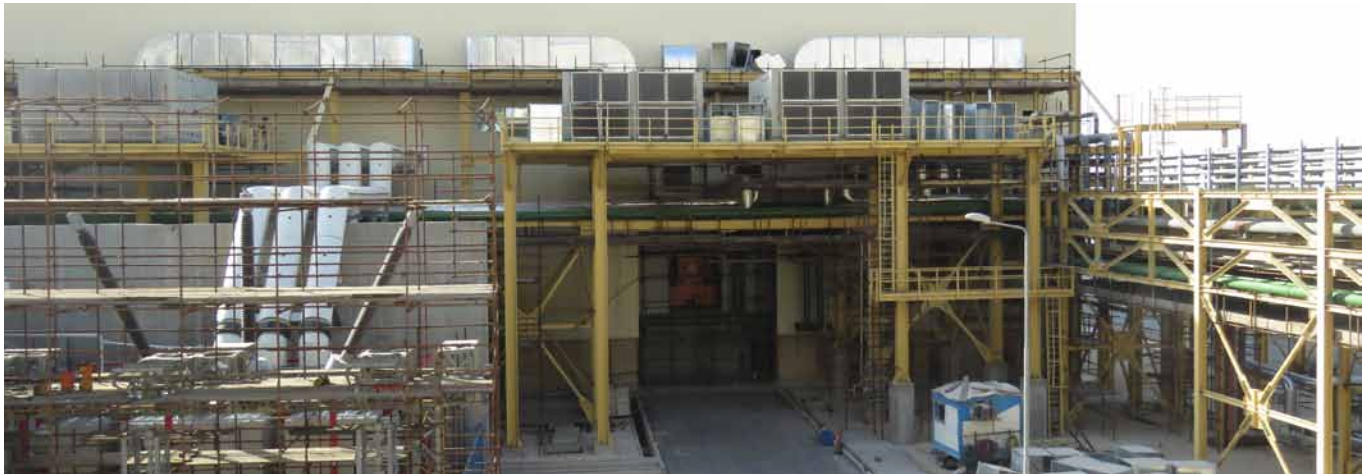
داکت های نصب شده HVAC سالن بخار واحد سوم
