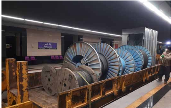
جابه جایی تابلو هوا و قرقره کابل
