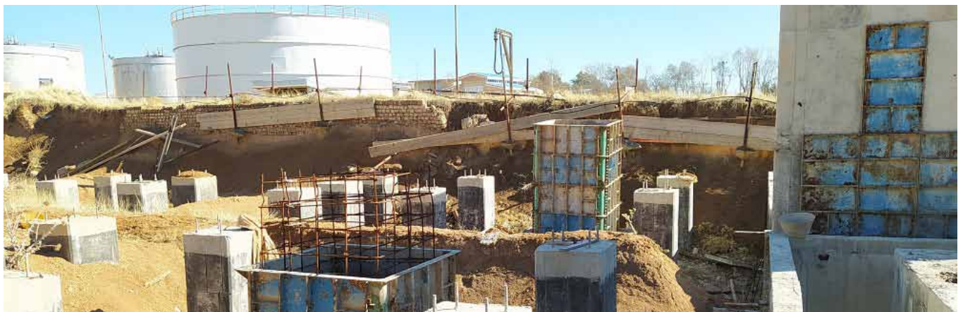
پدستال‌های ترانس‌های کمکی پست برق
