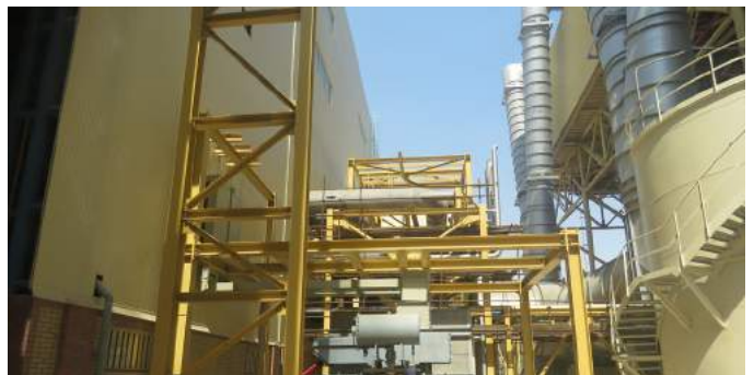
برق دار نمودن ترانس های کمکی واحد بخار شماره ۲
