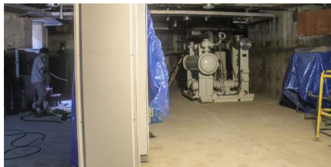
نصب کولرهای روغن ژنراتور
