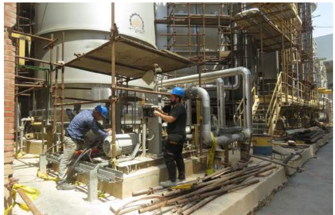
اجرای عملیات پیش راه‌اندازی مربوط به پمپ‌های CPH بویلر شماره ۳
