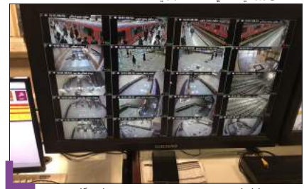
نصب و راه‌اندازی سرور سیستم سی سی تی وی در ایستگاه
