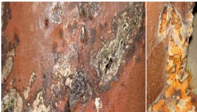
شکل ۱۰: خوردگی شیمیایی ناشی از SBR
