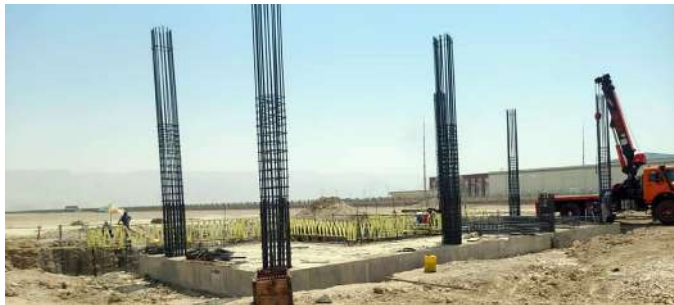
آزمایندگی در ستون‌های ساختمان اتاق کنترل
