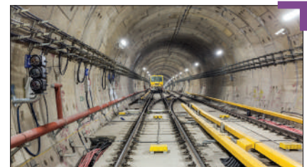
نمایی از تجهیزات سیگنالی‌نگ و تأمین توان نصب شده در تونل
