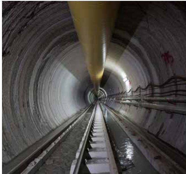
نمایی از تونل انتقال آب پروژه چند منظوره اوماویا
