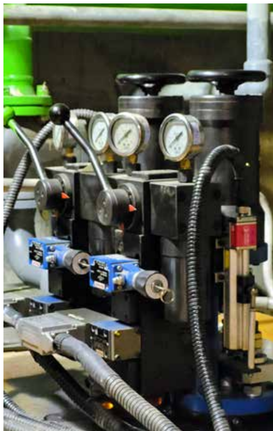
نمایی از تجهیزات سیستم کنترل درالوک
