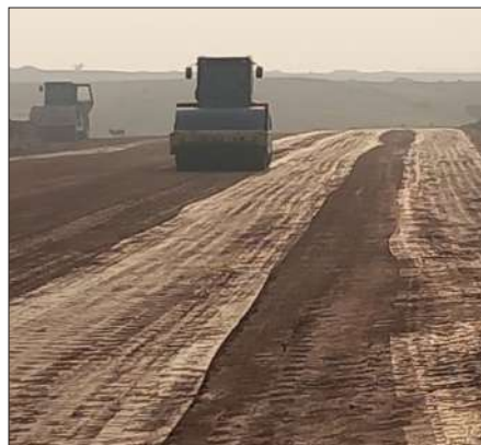
نمایی از عملیات احداث بخش BOP نیروگاه گازی مقیاس متوسط شوش توسط شرکت ساخت تجهیزات فراب
