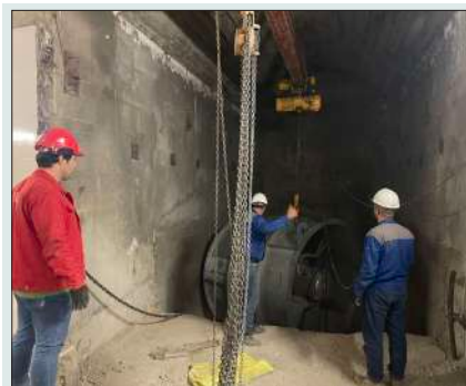
پروژه خط ۷ متروی تهران - ایستگاه فن تونلی از ریل به سطح اتاق هوا ساز در ایستگاه قیام
