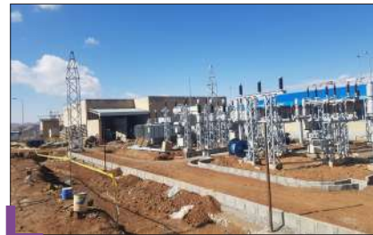
تاسیسات پست برق رازان
